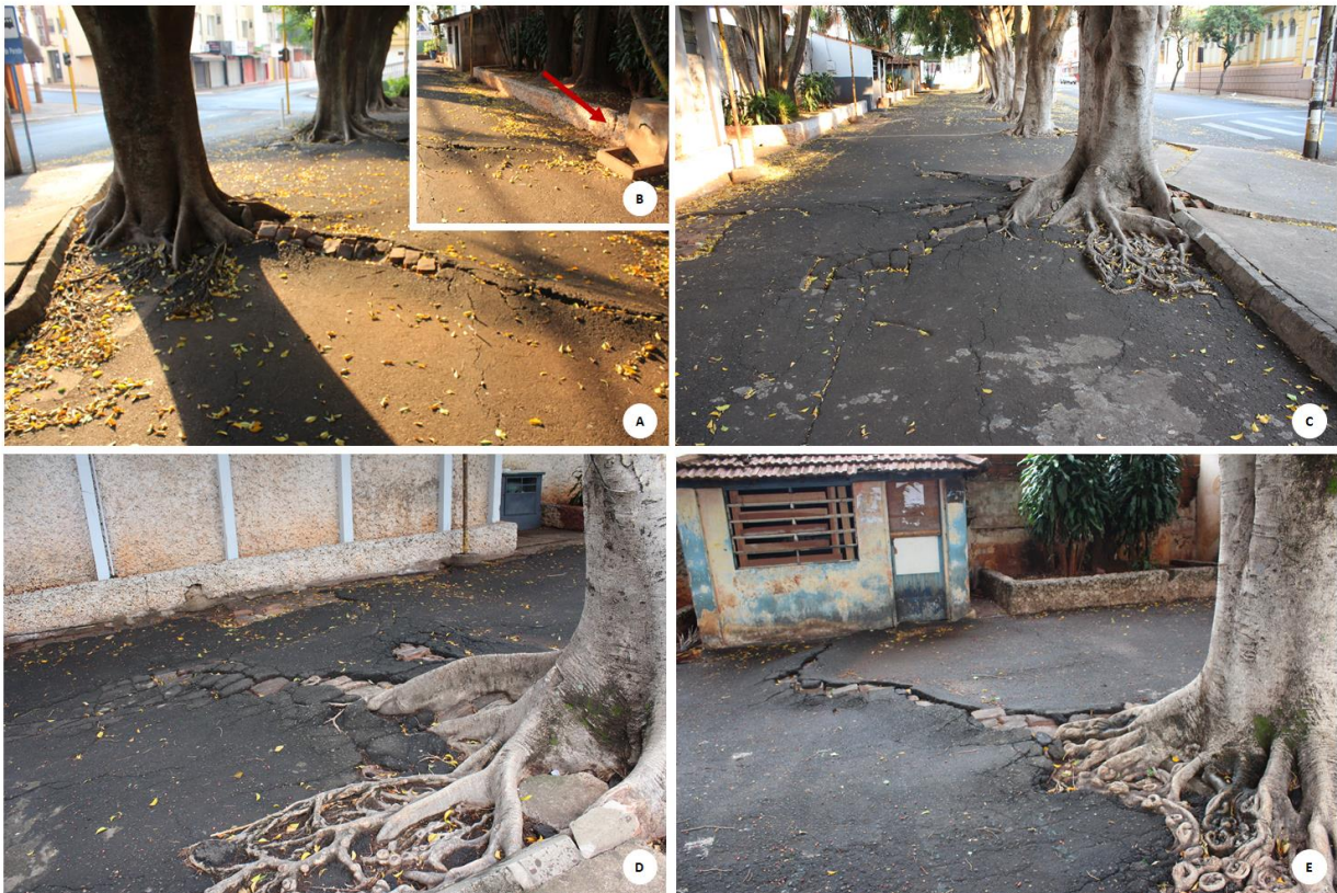
Figura 11: A. Detalhe da raiz de Ficus benjamina (indivíduo 11) que cresceu na direção do muro. B. Rachadura na estrutura da mureta (seta). C-D. Detalhe da raiz de F. benjamina (indivíduo 9). E. Raiz do indivíduo 2 de F. benjamina .
